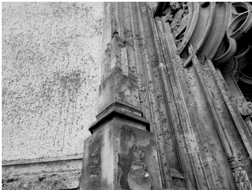
Farbflecken an der Fassade des Amtsgericht Wedding
